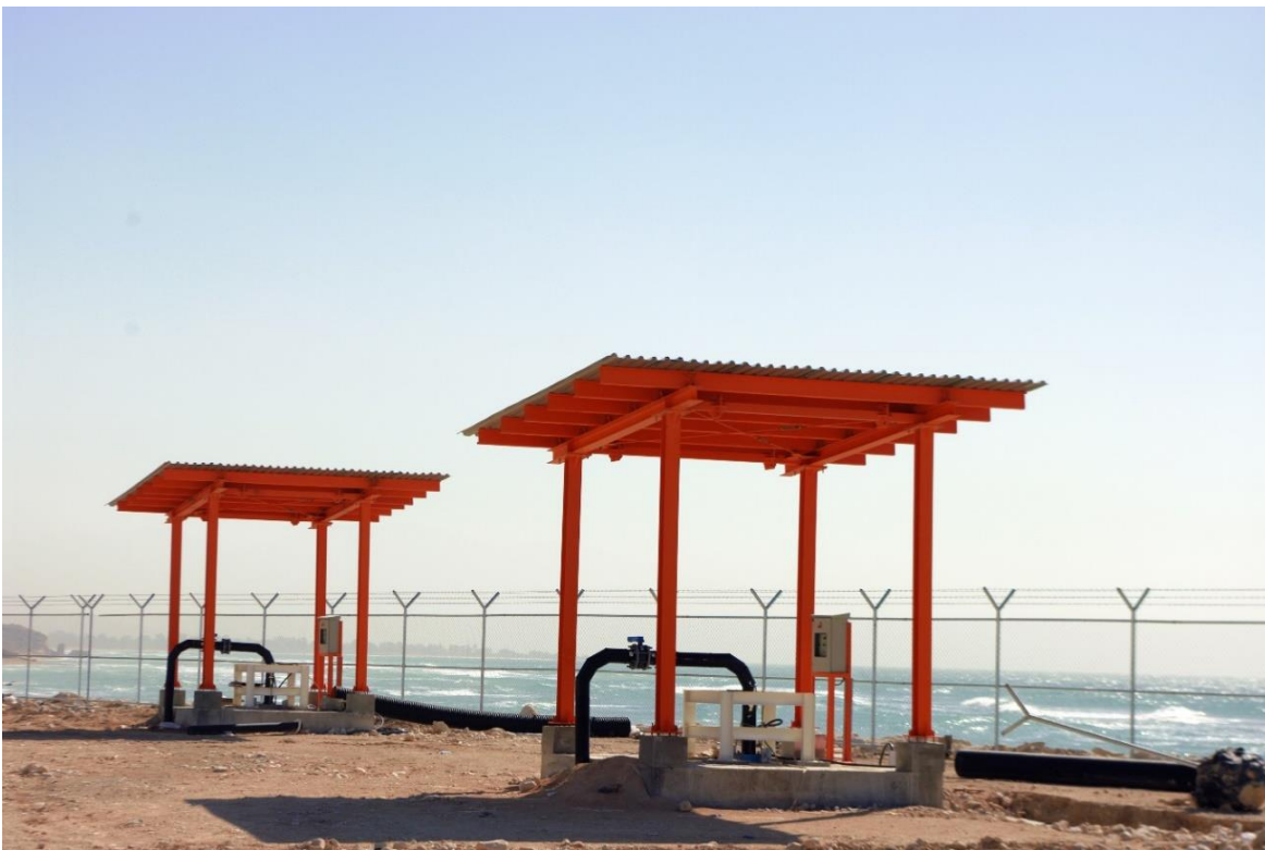
چاه‌های ساحلی Bore Hole و تأسیسات سرچاهی
