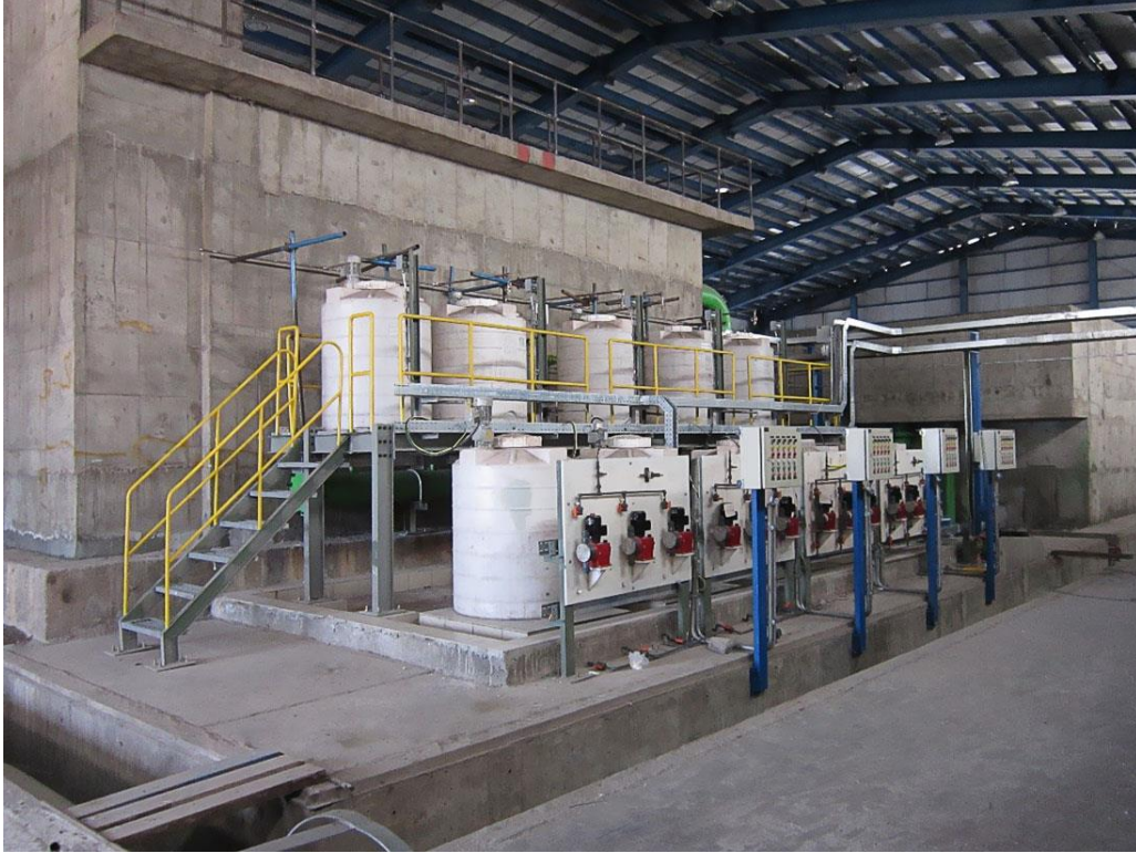
سیستم‌های تزریق مواد شیمیایی در واحد پیش تصفیه
