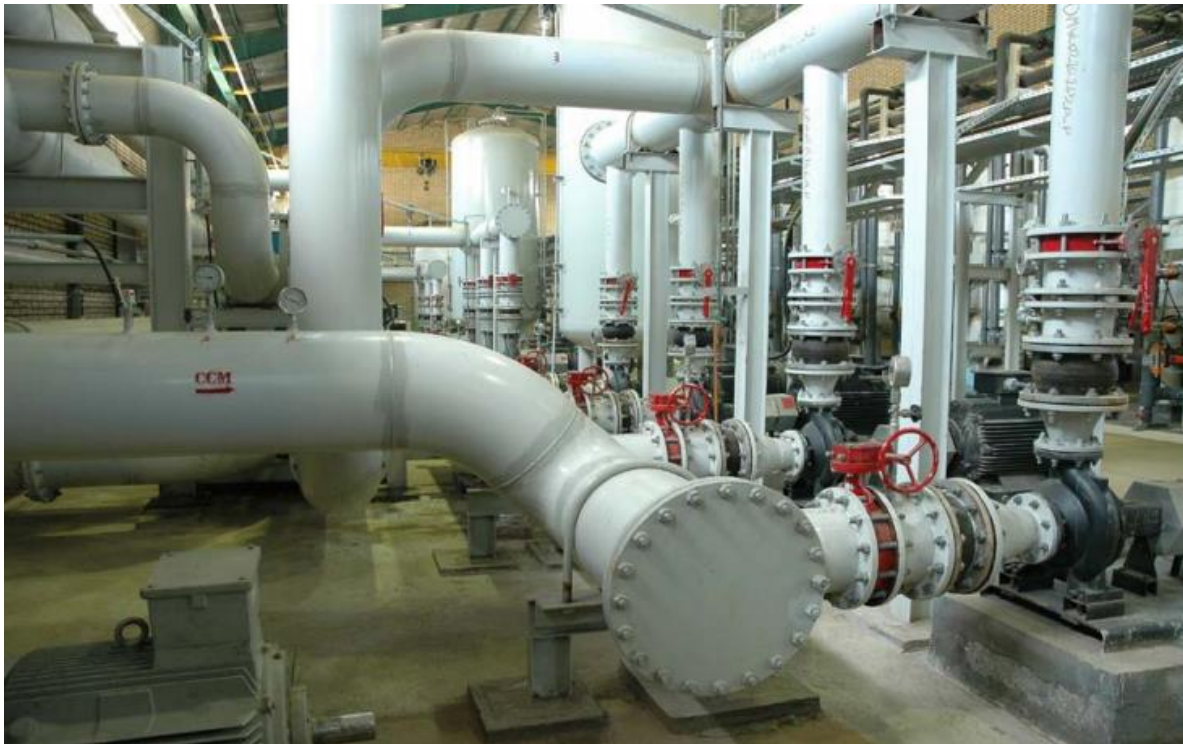
ایستگاه پمپاژ آب در گردش سیستم خنک کننده کوره و ترانسفورماتورها
