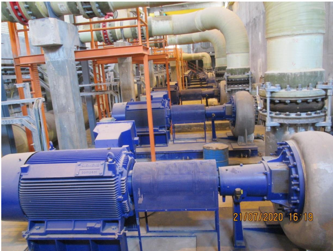
پمپهای تغذیه آب ورودی به RO
