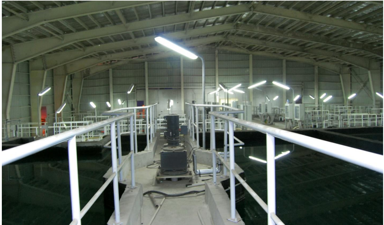
واحد پیش تصفیه آب دریا (فیلترهای شنی بلاوقفه Dyna Sand Filter)
